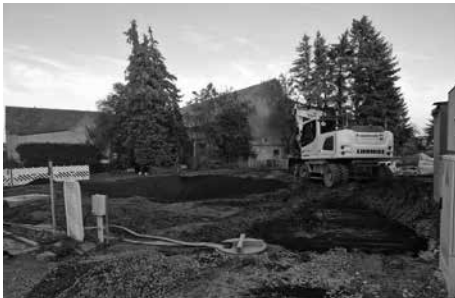
Regenrückhaltebauwerk Dorfstraße Steinbach
